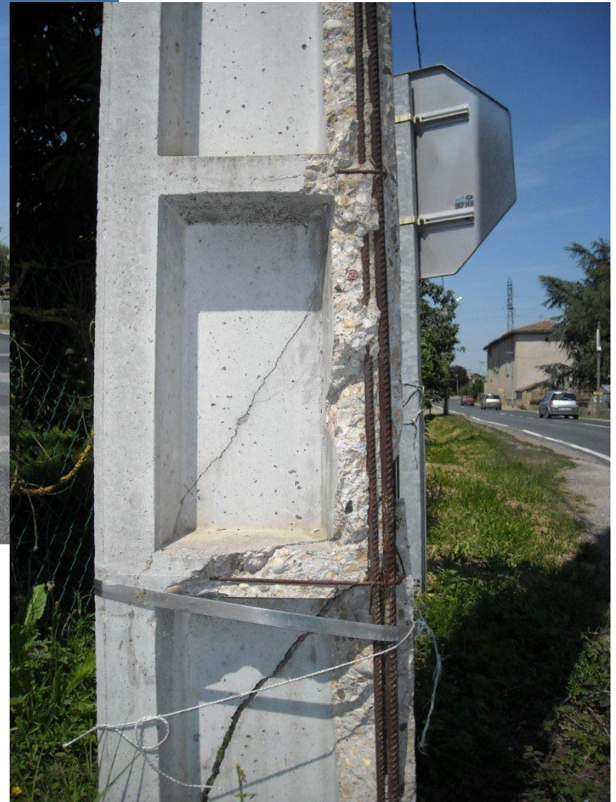
Poteau endommagé à Quincieux (Syder)
