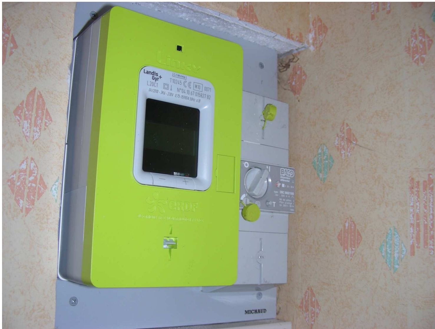
Compteur Linky monophasé (vert) – exemple 2
