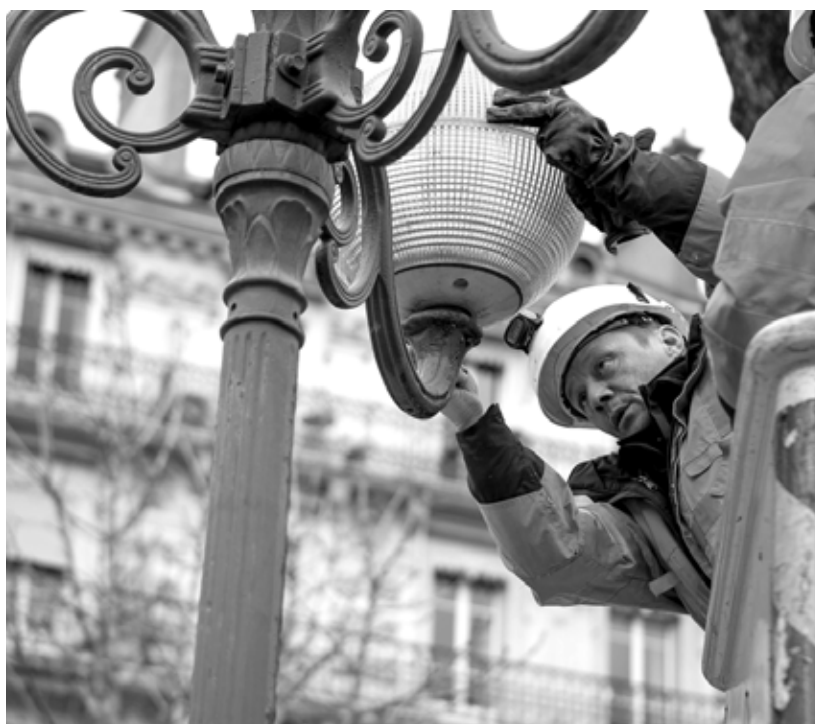
Suppression d'un éclairage inutile pour un meilleur confort et une baisse de la pollution lumineuse
