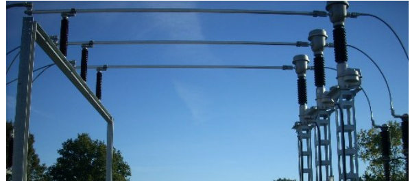
Des jeux de barres permettent de transporter le courant entre les différentes installations du poste.
