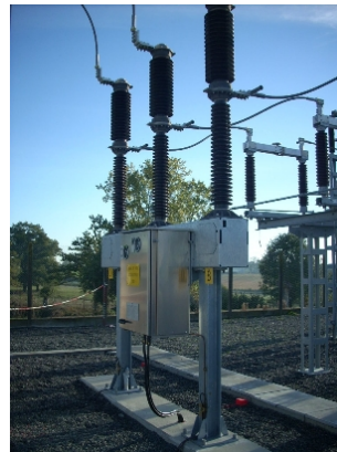
Des disjoncteurs protègent les installations électriques contre les défauts et les surcharges.
