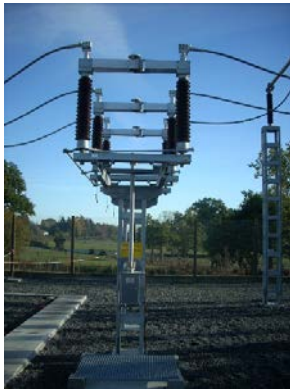
Des sectionneurs assurent une coupure visible des circuits électriques et permettent l'exploitation du réseau.
