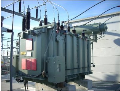
Les transformateurs modifient la tension.
